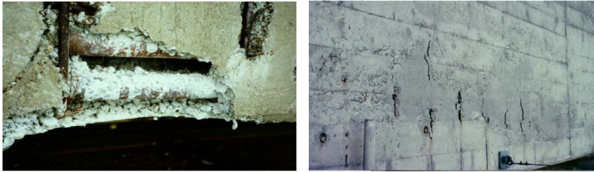
Fig.6 – Pont de Peney, défauts.
