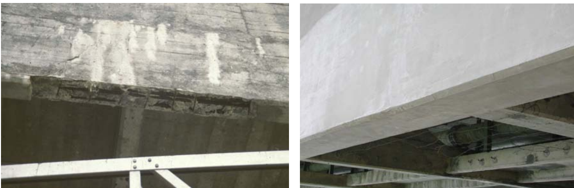
Fig.9 – Pont de Peney : vue d'un sommet avant les travaux en 1993 (à gauche), et en 2009, 15 ans après les travaux (à droite).
