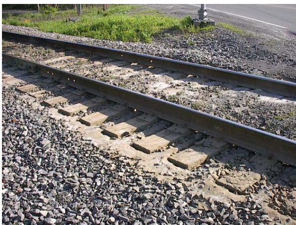
Photo 4.1 - Remontée boueuse liée à un mauvais drainage et à une zone de traverses danseuses en sortie de passage à niveau
