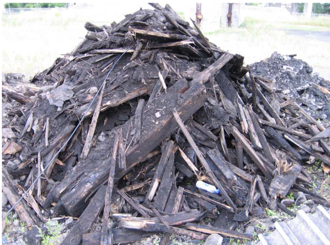
Photo n° 2. Nombreux débris provenant de la tranchée TE-07-04
