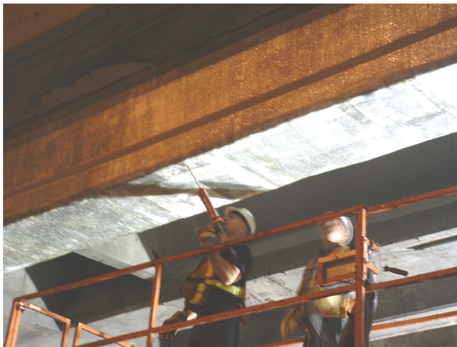
Figure 17 : Injection avec une résine époxy à prise rapide de la bande EC2 au pont de l'autoroute Chomedey (A-13) (2006-06-17)
