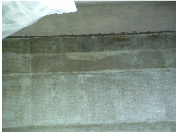
a) Vide sous le chemisage causé par un défaut dans le béton (2004-09-08)
