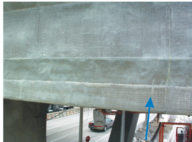
b) Bande #31 de la poutre est Pli dans le chemisage
