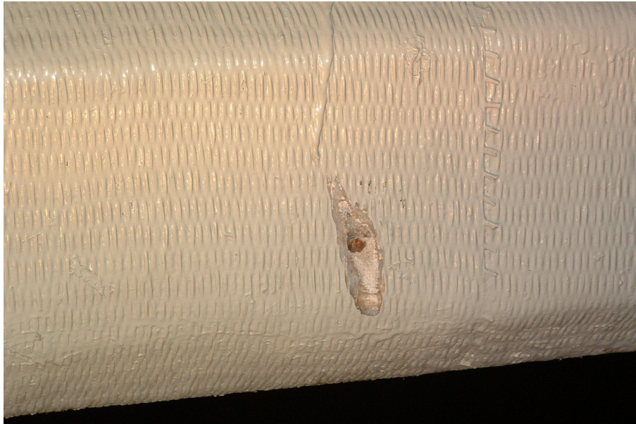
Figure 37 : Ancrage métallique coupé au raz du béton au pont de l'autoroute Chomedey (A-13) (2009-05-21)
