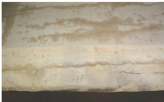
a) Béton fissuré; zone de référence non chemisée
