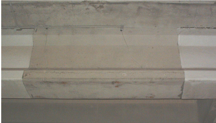
Figure 24 : Fissure et taches de rouille résultants de la corrosion des armatures au pont de la rue Halpern (2006-09-25)
