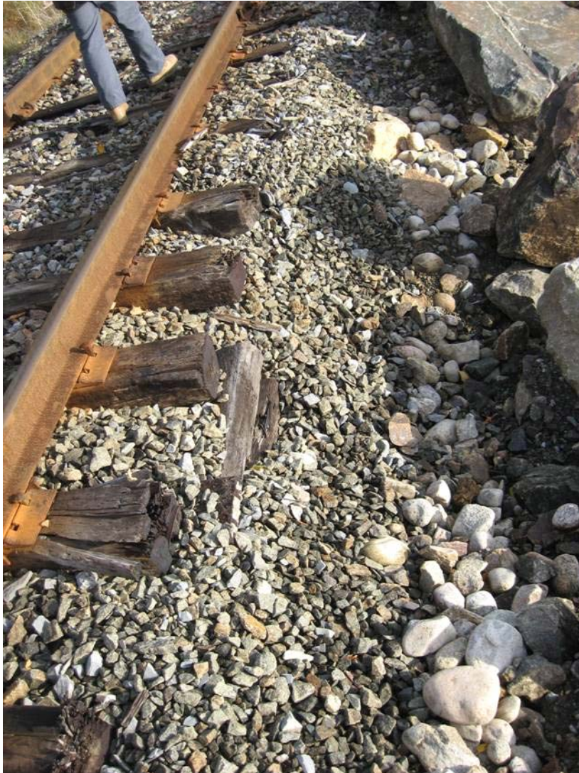
Érosion au point milliaire 76.15 près de Saint-Irénée
