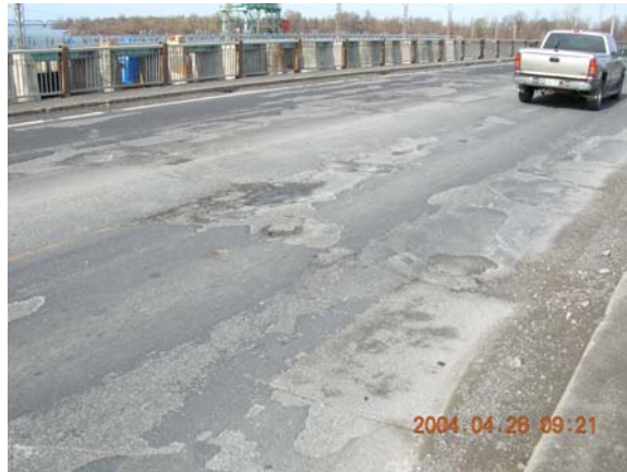
Photo 2 : Mauvais état de la dalle et de la surface de roulement du pont Monseigneur-Langlois avant les travaux
