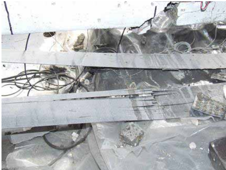
Figure 10 – Mode de rupture pour L4
