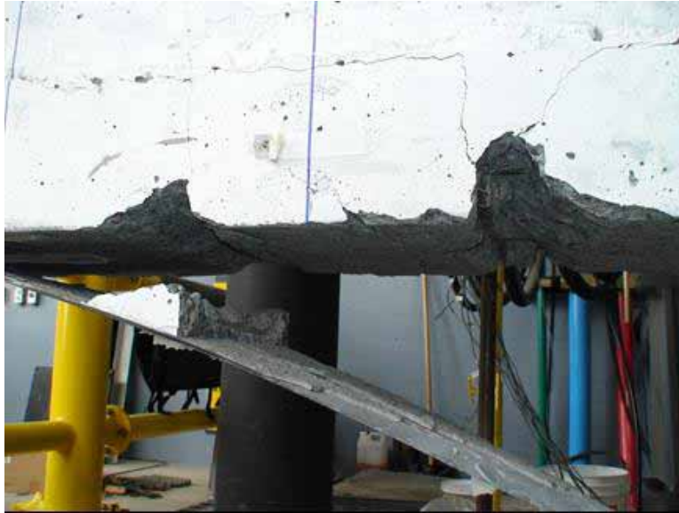
Figure 7 – Mode de rupture pour L1
