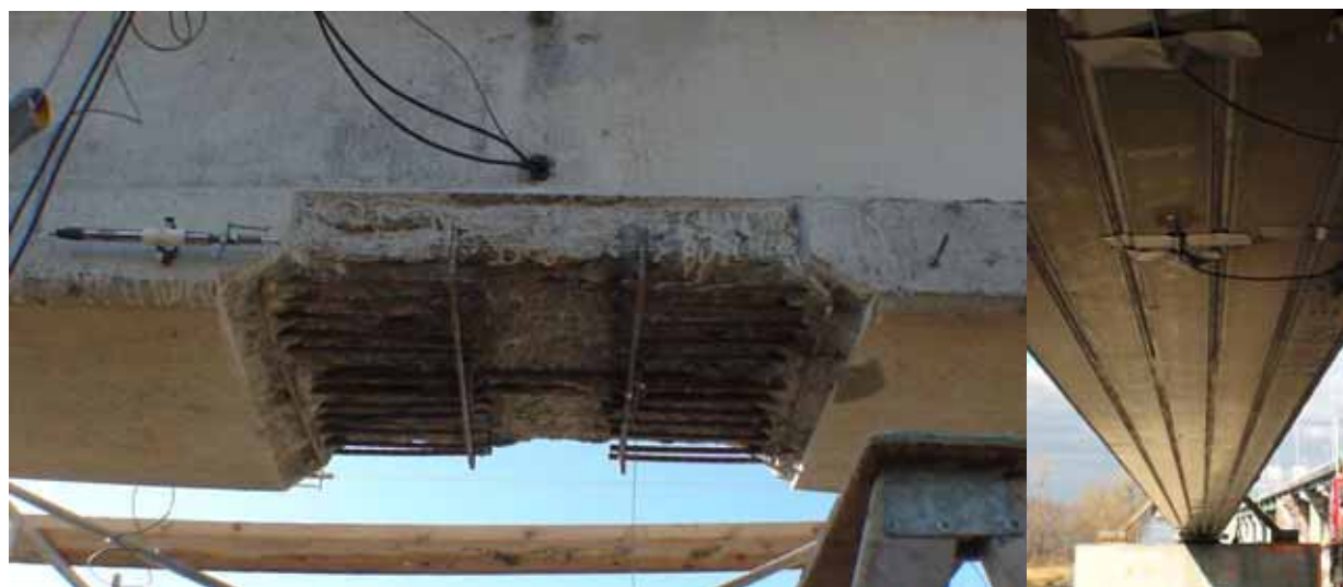
Figure 15 – Endommagement et réparation
