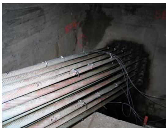
Figure 15 : Jauges SOFO, section de câble dans la chambre d'ancrage
