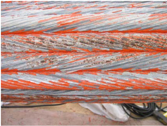
Figure 6 : Détail de deux types de corrosion
