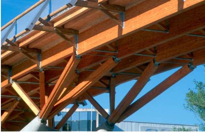
Pont de Crest - Assemblage des contrefiches sur les nervures du tablier et sur l'appui béton
