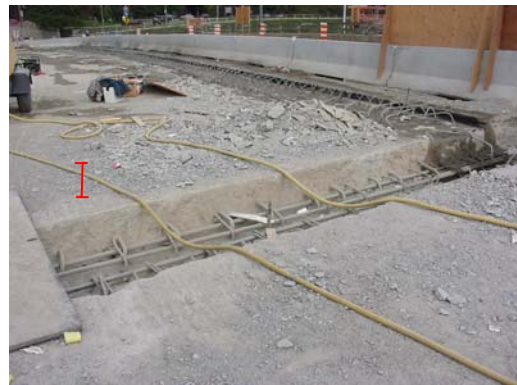
Photo 2 État du recouvrement à proximité de la bande médiane centrale
