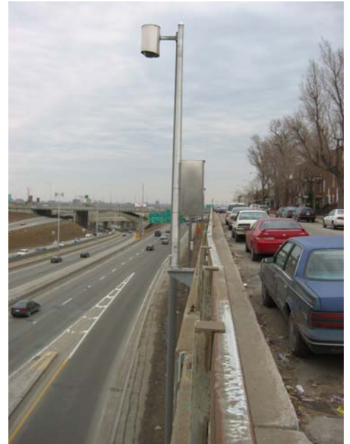
18- Disposition du redresseur
