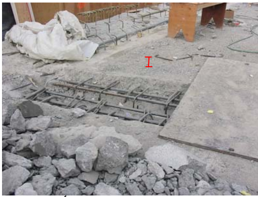
Photo 1 État du recouvrement à proximité du trottoir
