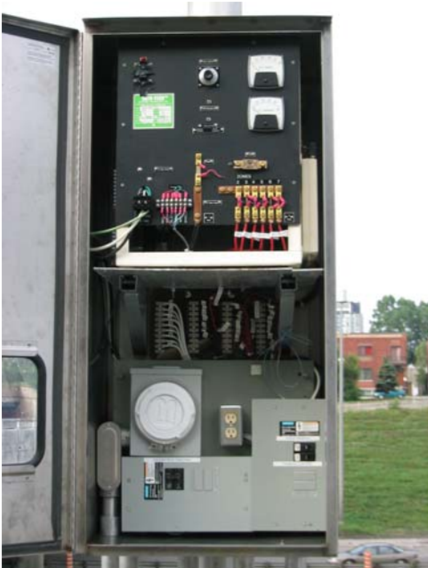
16- Vue d'ensemble du redresseur et SAD vue intérieure
