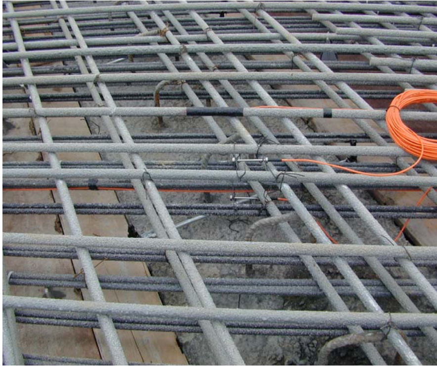
Fig. 1 Instrumentation à l'aide de capteurs à fibre optique
