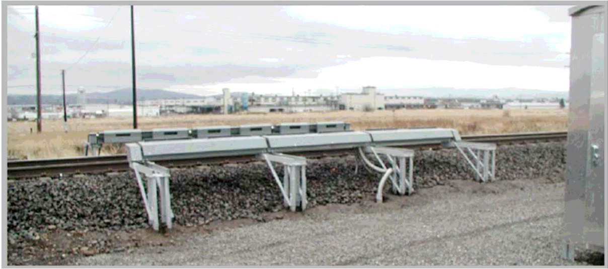
Figure 5 Système de détecteurs acoustiques en voie 15
