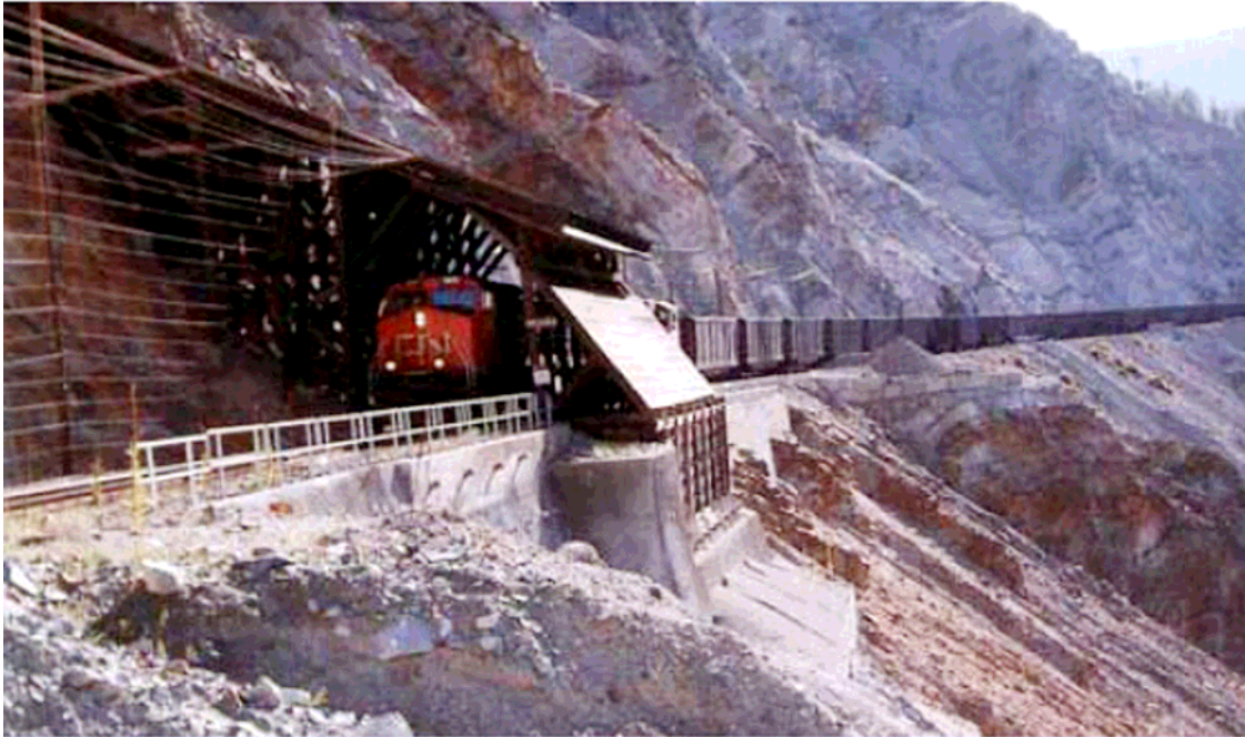
Figure 16 Une barrière anti-chutes sur la voie de CN 56
