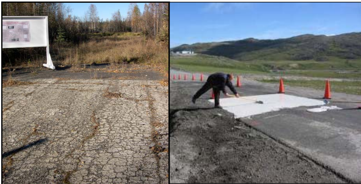
Figure 8: a) État d'une section avec surface réfléchissante 30 ans après sa construction (site expérimental CRREL, Alaska) et b) installation d'une section d'essai sur la route d'accès à l'aéroport de Salluit en 2006
