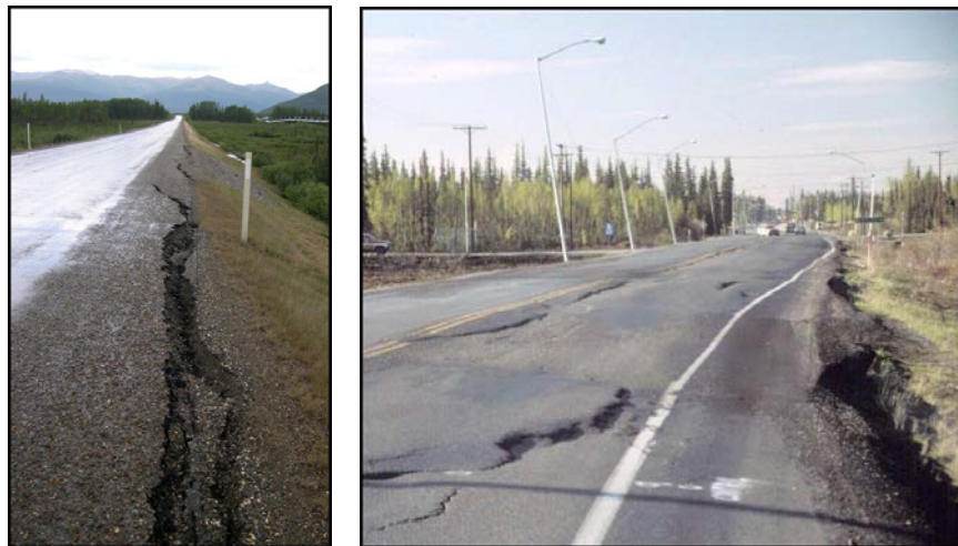
Figure 5: Fissures longitudinales dans l'accotement sur l'Elliot Highway (Alaska) et rotation des épaulements sur Farmer's Loop Road (Fairbanks, Alaska)
