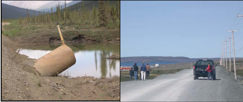
Figure 1: Enfoncement d'une route dans un thermokarst (Elliot Highway, Alaska) et présence d'ondulations sur la route d'accès à l'aéroport de Umiujaq (Nunavik)
