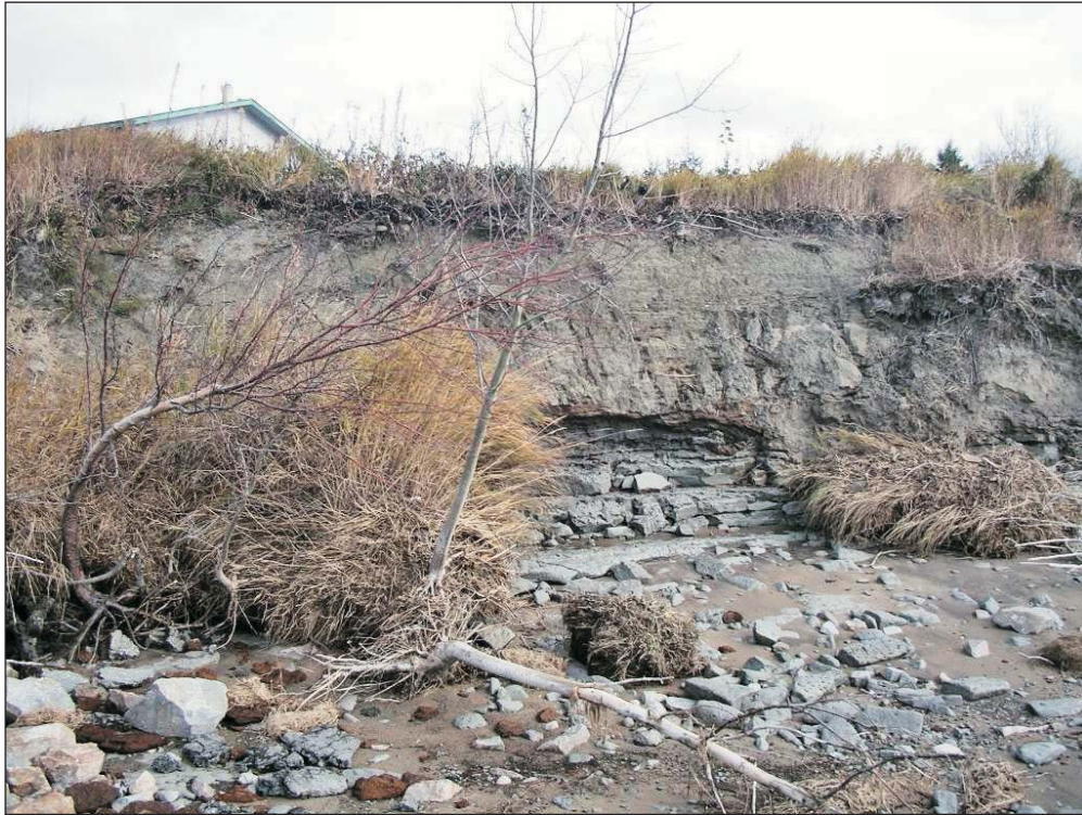
Photo 7. Portion ouest de la falaise située à l'arrière du 535 route 138 (Rag-14)
