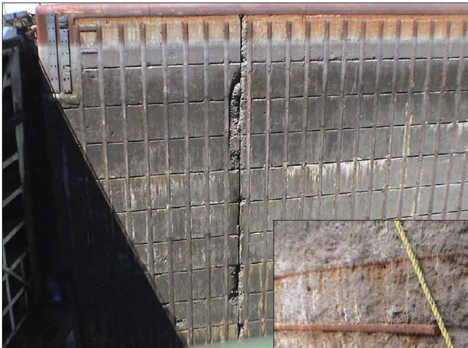
Mur nord de l'écluse Snell avec revêtement vertical (À signaler, le dommage typique au joint vertical des monolithes)
