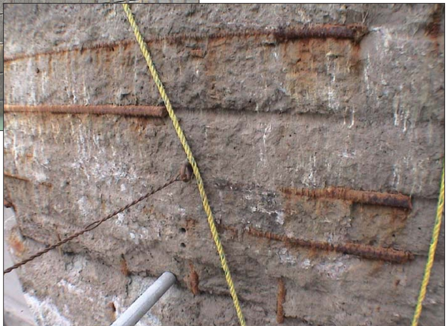
Détérioration de la face du mur de béton à l'écluse 7 du canal Welland (À signaler, les barres d'armature exposées dans la zone endommagée)
