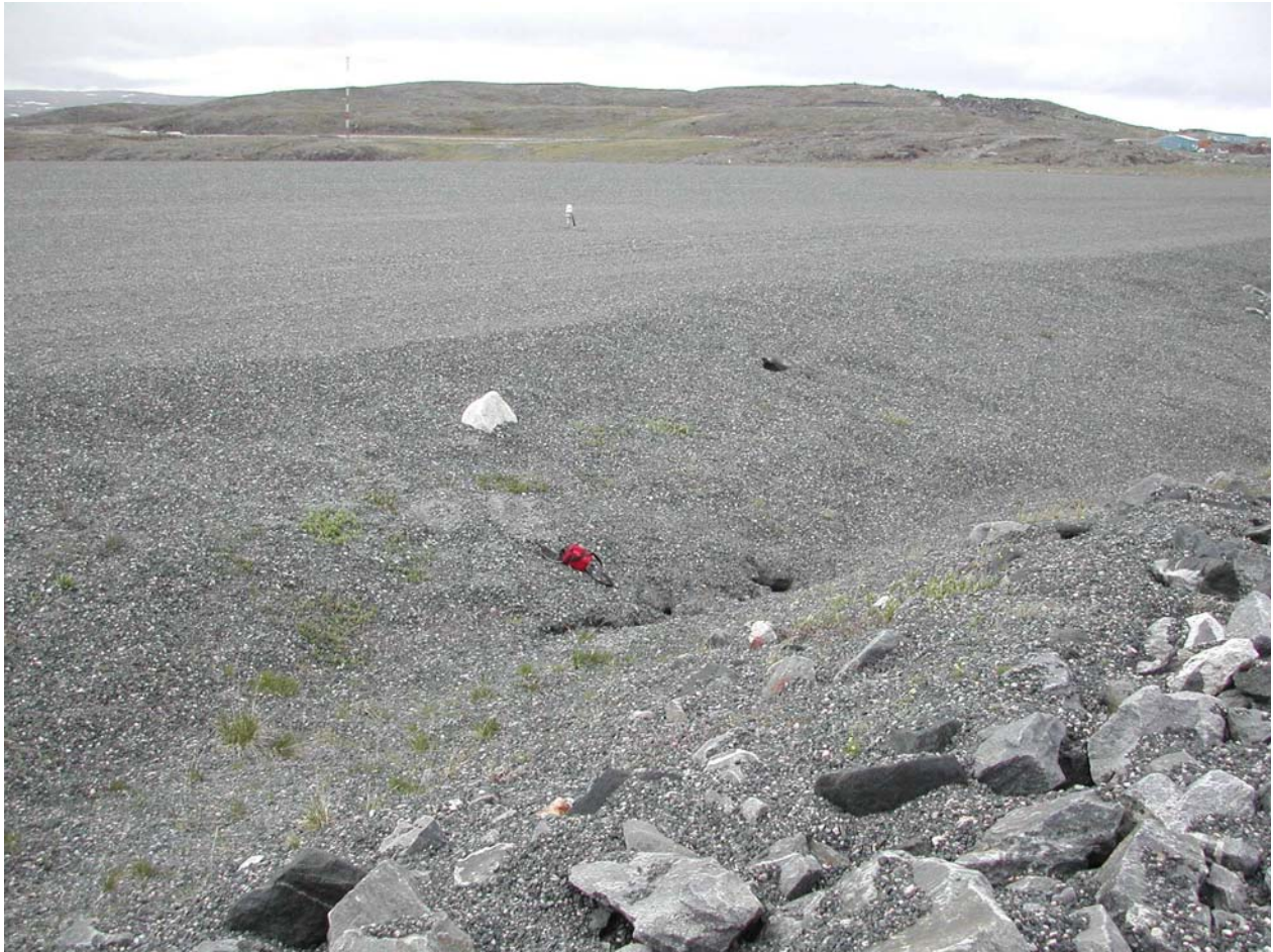
Figure 73 Trou d'infiltration d'eau sur la bordure est de la piste de Salluit
