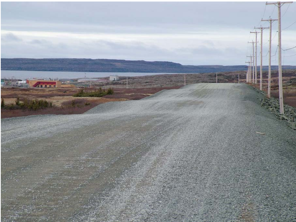
Figure 9 Affaissements importants accompagnés de processus de thermokarst sur la route d'accès
