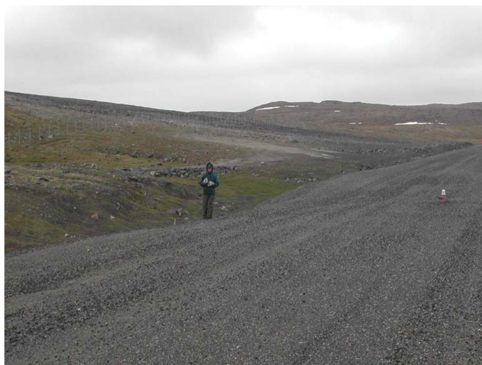
Figure 56 Affaissement sur la bordure est de la piste, près des ponceaux
