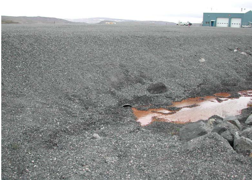
Figure 69 Colmatage du talus et du ponceau de la voie de circulation de la piste de Salluit
