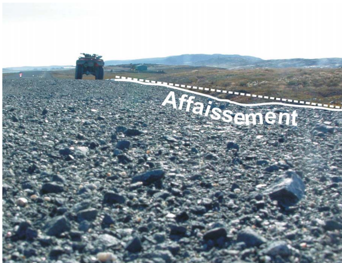
Figure 36 Affaissement sur l'accotement nord de la piste d'atterrissage d'Akulivik
