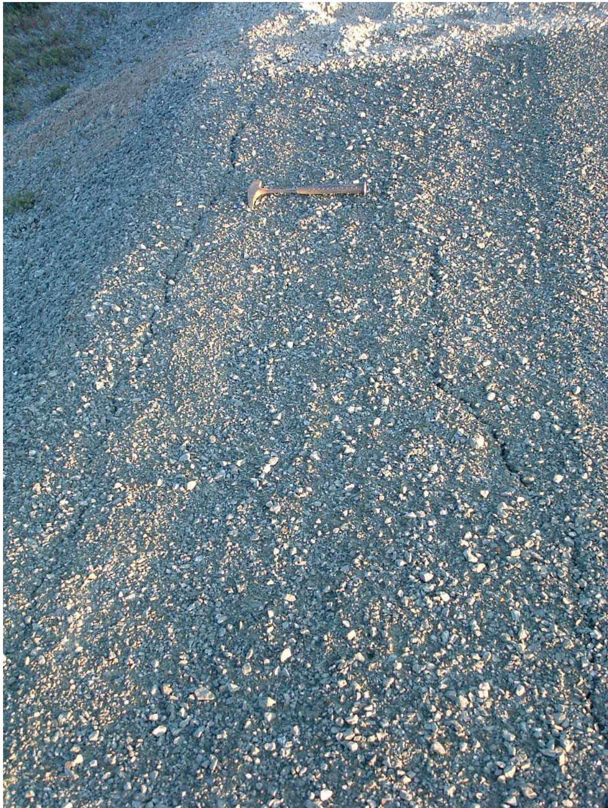
Figure 90 Fissures de tension dans la zone construite en déblai de la piste d'atterrissage de Kangirsuk
