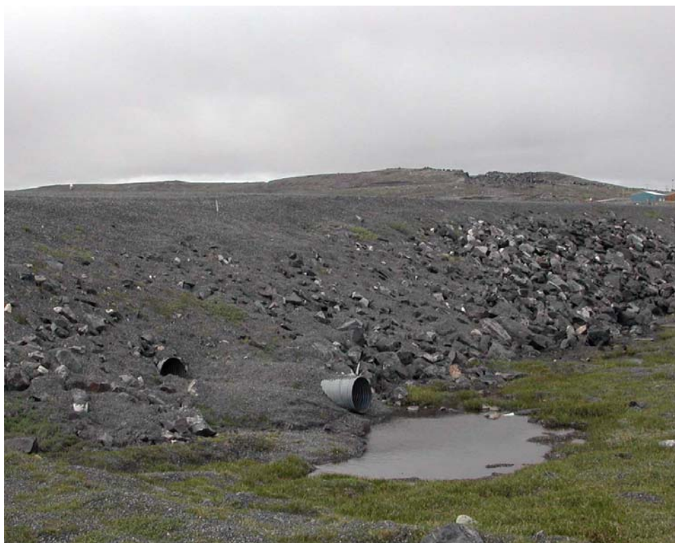
Figure 58 Ponceaux affaissés et inopérants au chaînage 2+040 m du côté est de la piste
