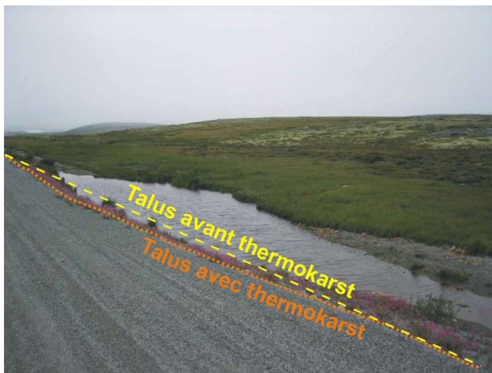
Figure 26 Processus thermokarstique associé à un affaissement du talus en bordure nord de la piste
