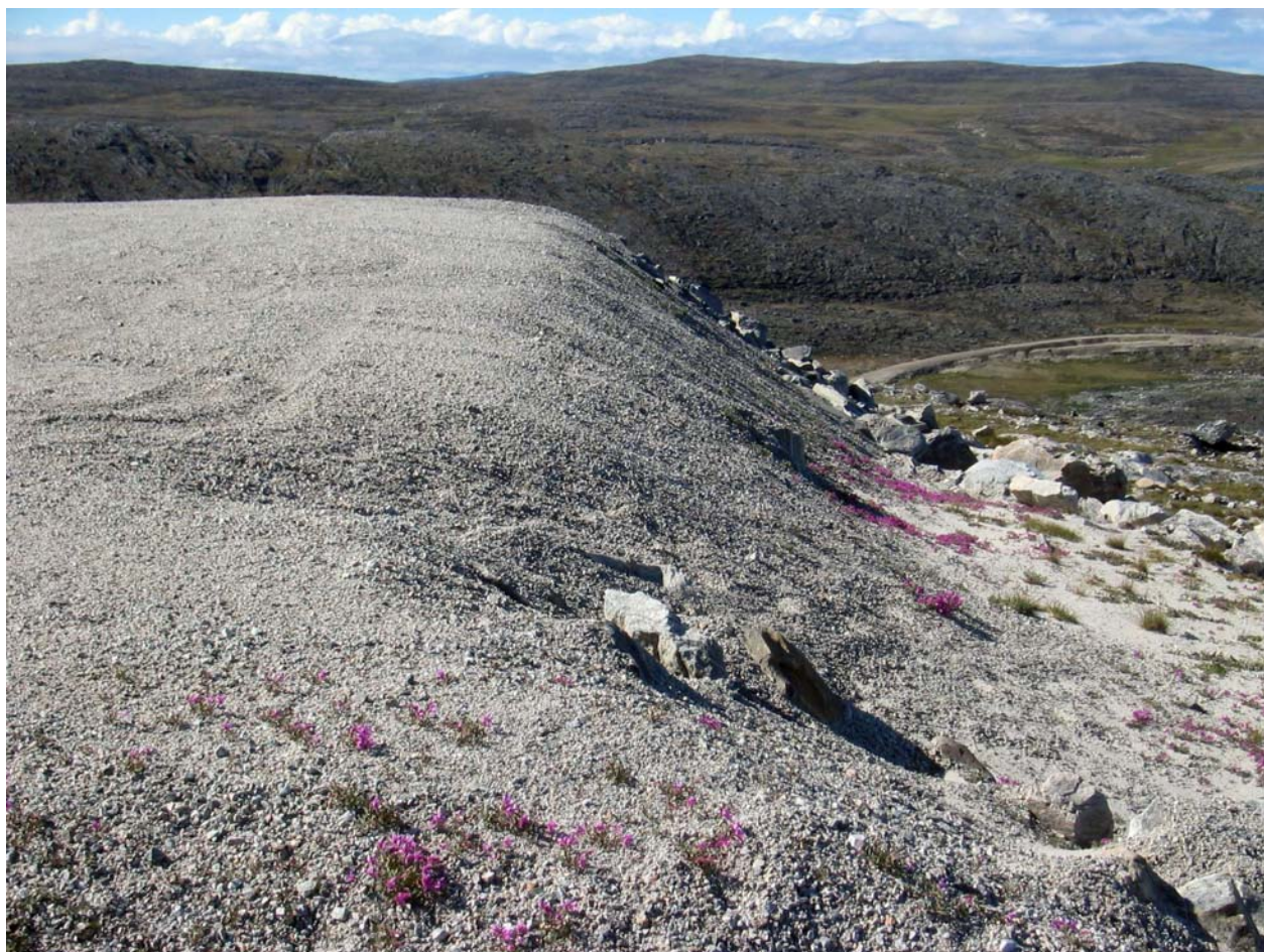
Figure 75 Couche de MG-20b et affaissement sur les talus du remblai de la piste de Kangiqsujuaq
