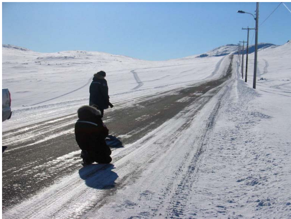
Figure 59 Tronçon de la route de l'aéroport sujet au tassement en hiver 2006
