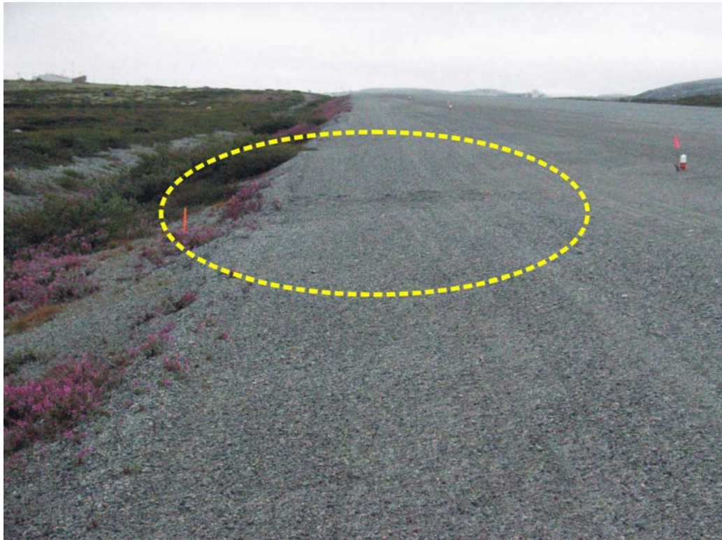
Figure 12 Tassement en bordure sud de la piste d'Inukjuak
