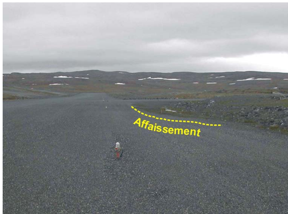
Figure 55 Affaissement près de la voie de circulation de la piste de Salluit
