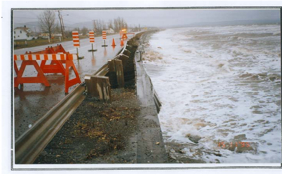
FIGURE 2 : BRIS DU MUR DE MARIA LORS D'UNE TEMPÊTE EN 1995 (DIRECTION EST) AYANT FAIT L'OBJET DE TRAVAUX D'URGENCE, SECTEUR IMMEDIATEMENT A L'EST DU RUISSEAU MARTIEN (15 NOVEMBRE 1995)
