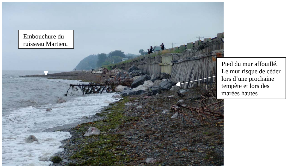
FIGURE 3 : PIED DU MUR AFFOUILLE A MARIA (VUE RAPPROCHEE EN DIRECTION OUEST), SECTEUR IMMEDIATEMENT A L'EST DU RUISSEAU MARTIEN (19 JUILLET 2004)
