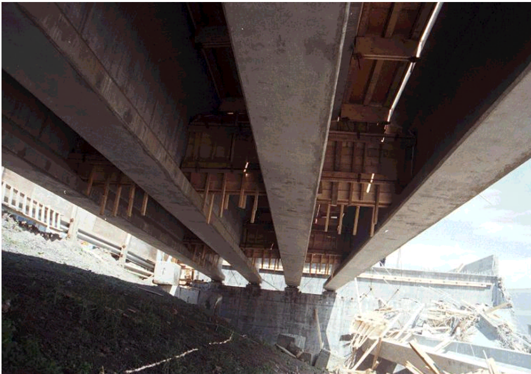
Figure. 5.5 Vue de la travée 4 et de la culée 5 après l'effondrement (photo 280.2.20)
