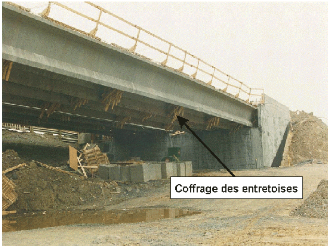
Figure 3.17 Déformation des coffrages des entretoises entre les poutres de la travée 4 (photo SQ.B22)
