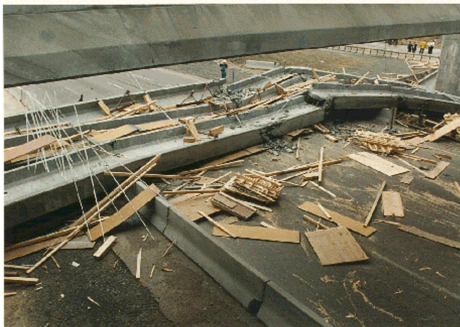
Figure 3.10 Vue vers le sud des poutres 2 à 4 de la travée 3 tombées sur la voie nord de l'autoroute 15 (photo SQ-B37)
