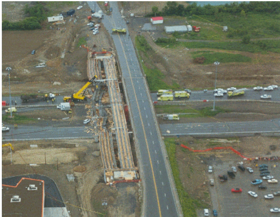
Figure 3.1 Vue du pont vers l'ouest après l'effondrement (photo SQ-A16)
