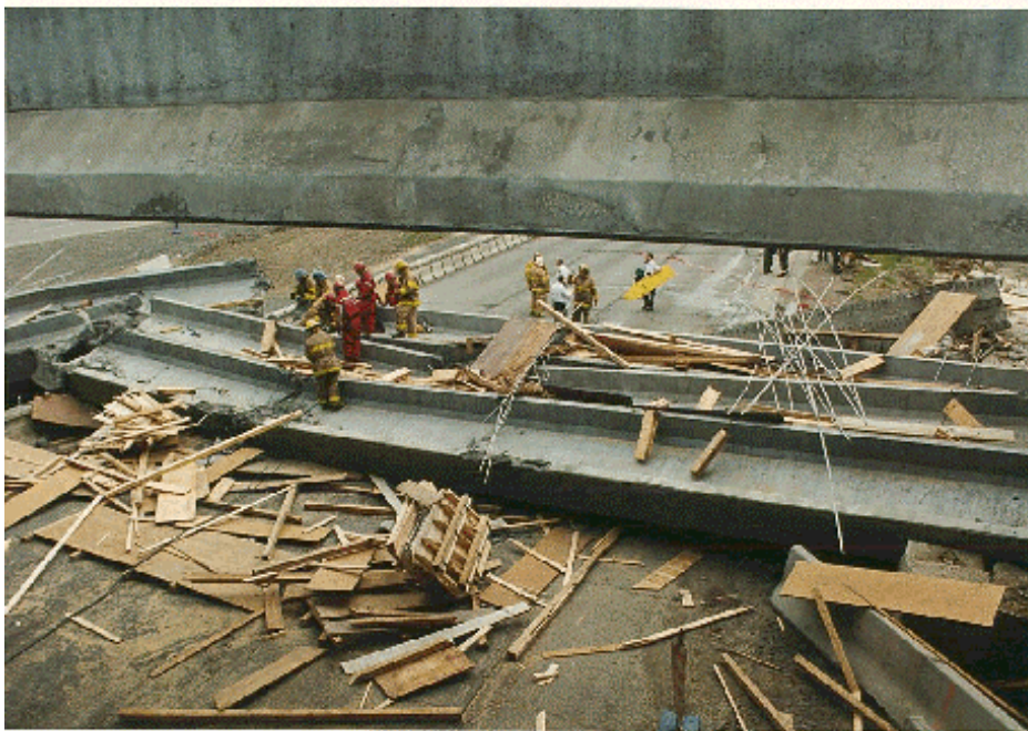
Figure 3.9 Vue vers le sud des poutres 2 à 4 de la travée 2 tombées sur la voie sud de l'autoroute 15 (photo SQ-B31)
