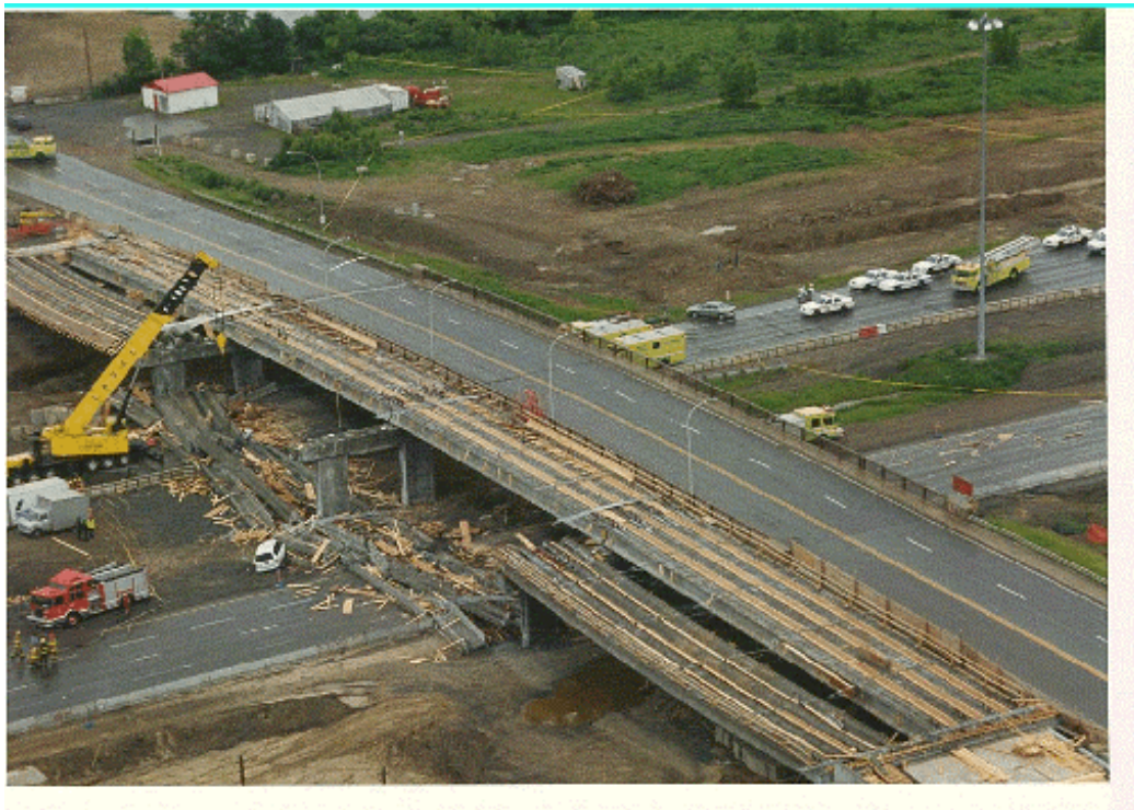
Figure 3.2 Vues du côté sud du pont après l'effondrement (photos SQ-C12 et SQ-C13)
