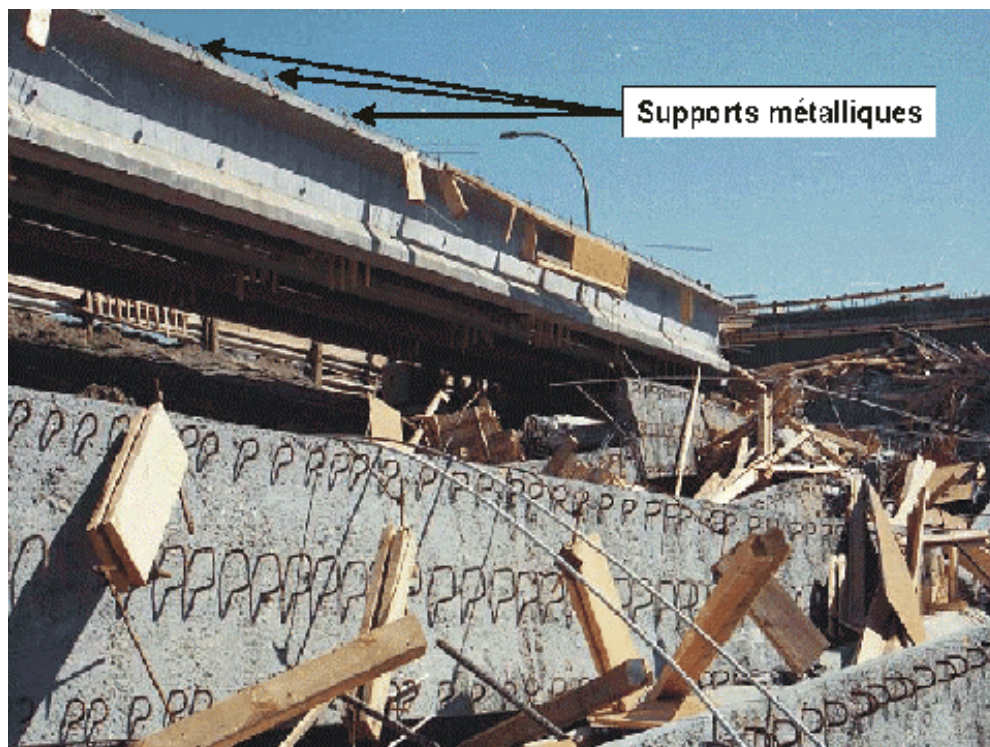
Figure 3.16 Flexion des tiges métalliques qui supportaient le coffrage de la dalle (photo 330.2.12)
