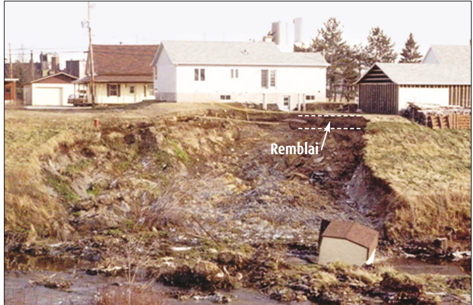
Figure 13 : Remblai mineur en sommet de talus
