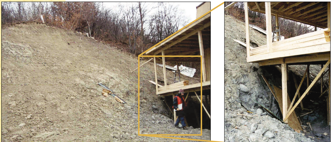
Figure 14 : Déblai à la base du talus
