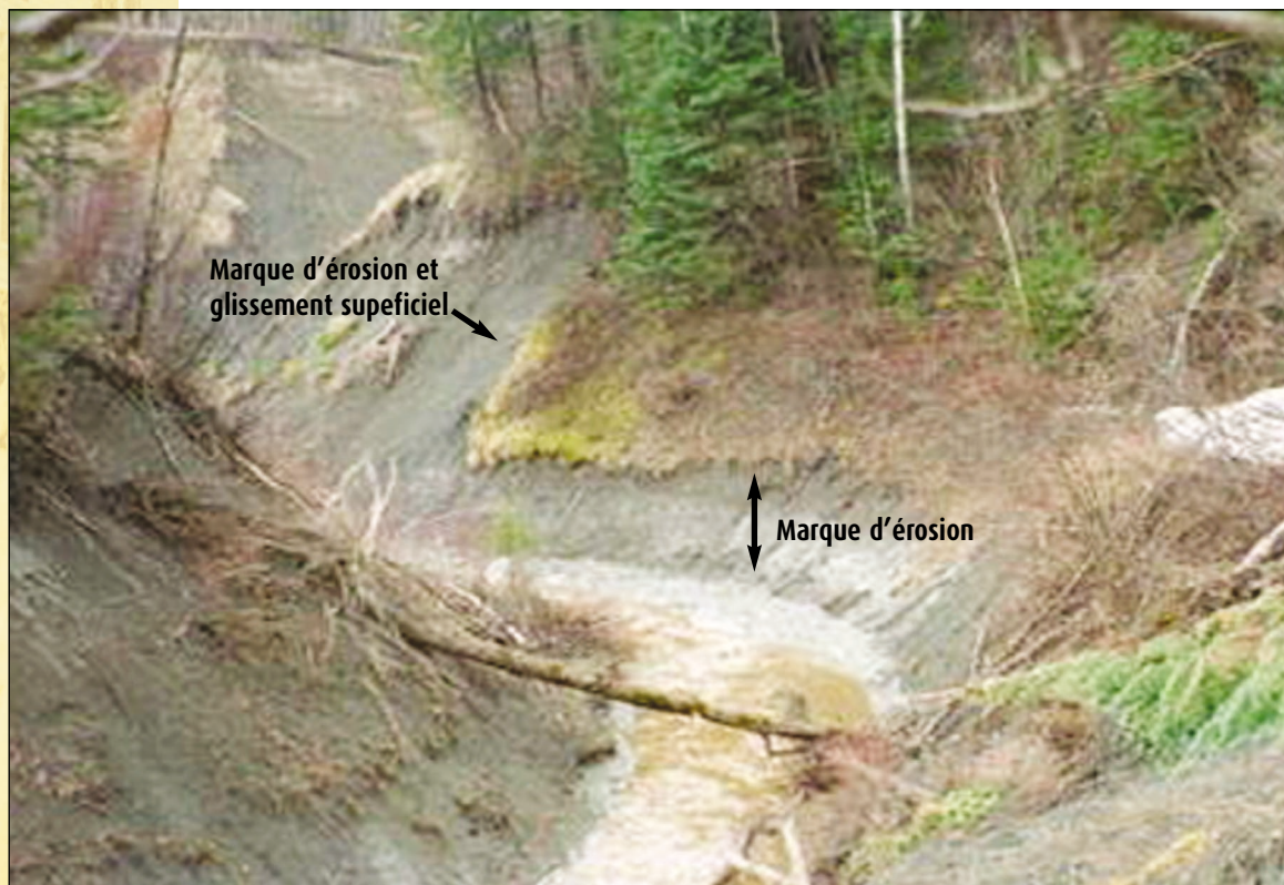
Figure 10 : Marques d'érosion et de glissement superficiel
