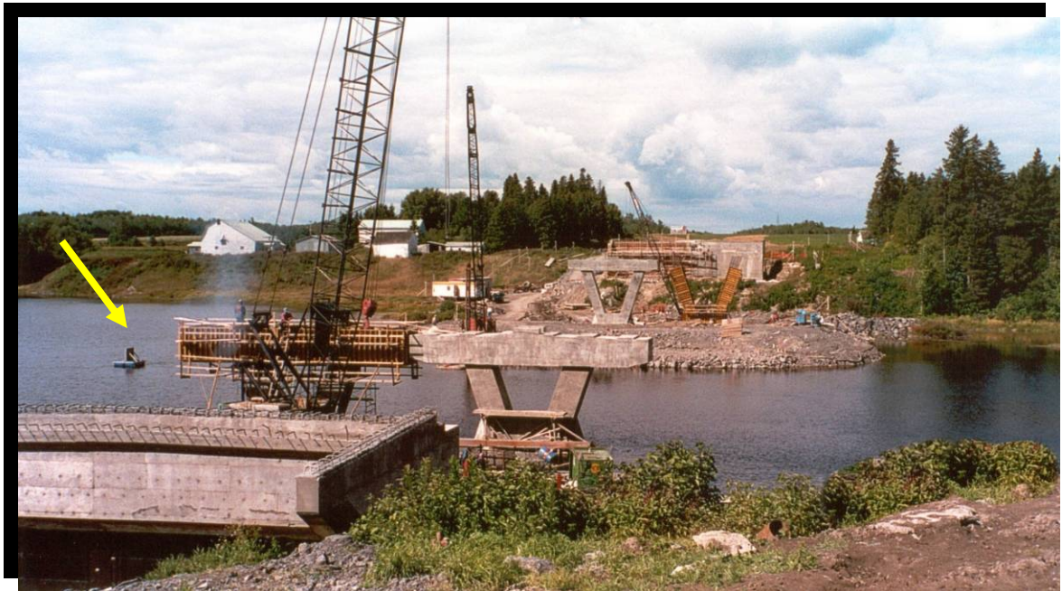
FIGURE 43 Balise installée conformément à la Loi sur la protection des eaux navigables. Autoroute 70 à Jonquière, pont de la rivière aux Sables. (2000.1046)
