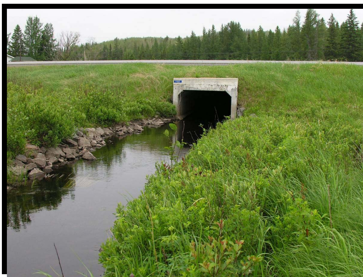
FIGURE 96 Ponceau rectangulaire en béton armé (PBA) dans la rivière Dorval. Enfouissement du radier du ponceau pour assurer la montaison du poisson. La faible pente du radier évite de reconstituer le lit du cours d'eau sur celui-ci. L'apport naturel de sédiments suffit. Engazonnement et plantation des bandes riveraines. Route 170 à Larouche. (2005.1111)
