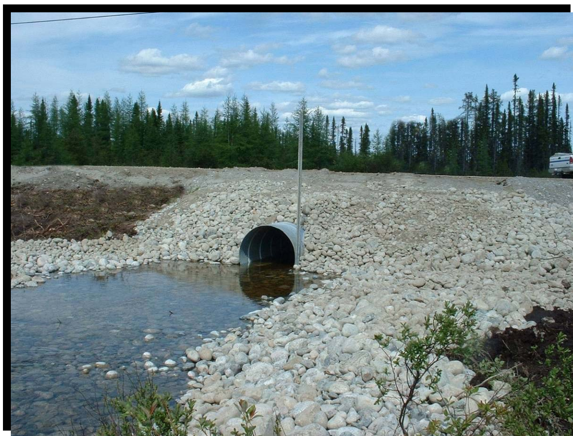
FIGURE 100 Ponceau circulaire en acier (TTOG) dans un cours d'eau du bassin versant du lac Opémisca. Enfouissement du ponceau pour assurer la montaison du poisson. Chemin d'accès au village des Cris d'Oujé-Bougoumou, Nord-du-Québec. (2003.1115)
