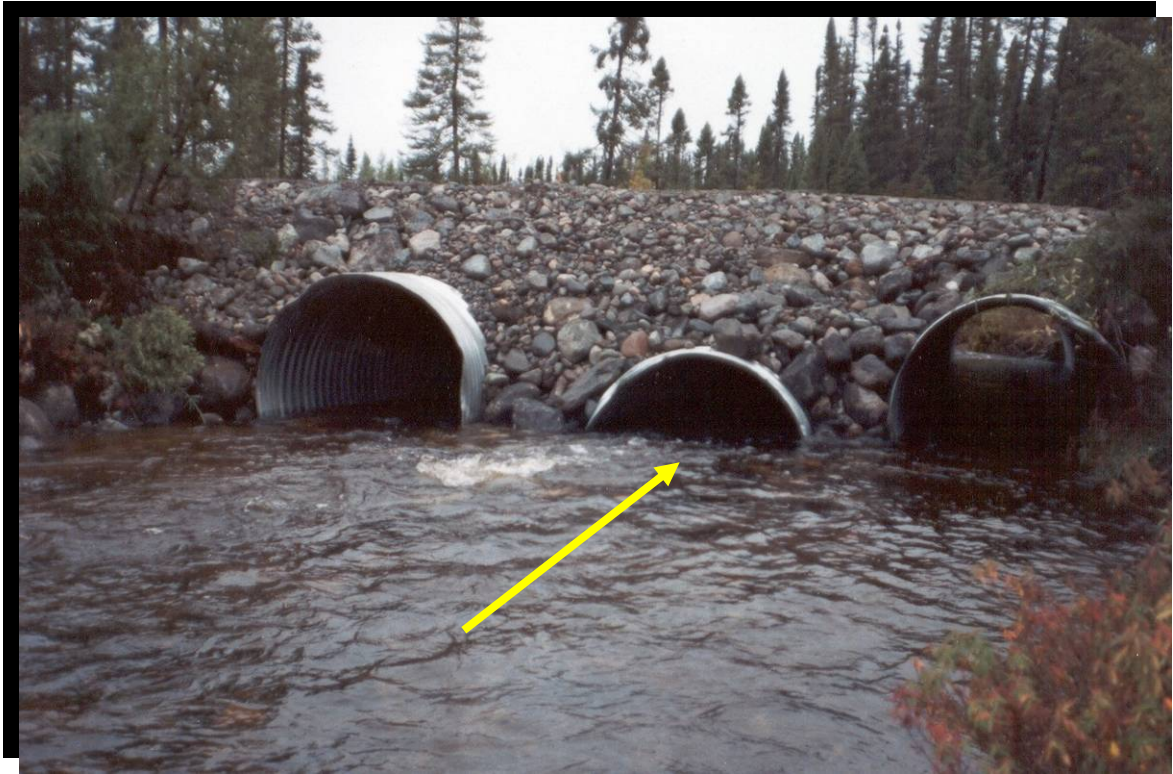
FIGURE 103 Ponceaux circulaires en acier (TTOG) installés en parallèle dans la rivière Bordeleau (chemin d'accès à une sablière). Photo prise en période de hautes eaux. Un seul ponceau doit respecter les critères assurant le passage du poisson (enfouissement et pente). Ce dernier doit être placé le plus bas de façon à concentrer le débit d'étiage. Stabilisation par empierrement du talus de la route et protection de la végétation existante. Route 167 Nord dans la réserve faunique des Lacs-Albanel-Mistassini-et-Waconichi, au kilomètre 271. (1997.1130)
