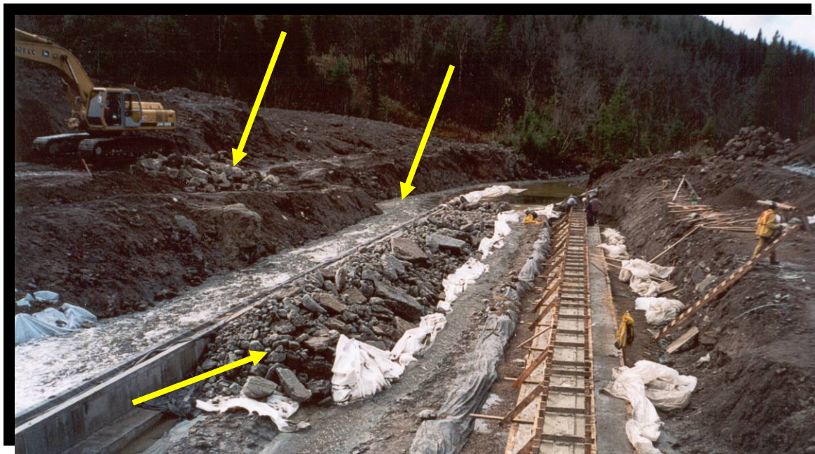
FIGURE 74 Canal de dérivation temporaire pour la construction des semelles d'un pont de type portique. Récupération du substrat du lit du cours d'eau. Malfaçon en raison d'un manque de mesures de stabilisation du canal et d'absence de mesures de contrôle de l'érosion sur les berges. (0000.1128)
