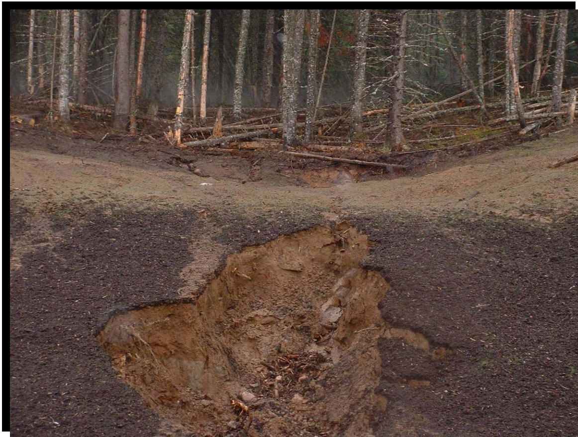
FIGURE 53 Ravinement au pied d'un vallonnement de terrain en haut de talus. (0000.1062) Défectuosité à corriger.
