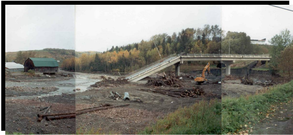
FIGURE 85 Pont à poutre de béton avec 2 piliers endommagé par le déluge des 19 et 20 juillet 1996. Route 381 à La Baie, rivière à Mars. (1996.1102)
