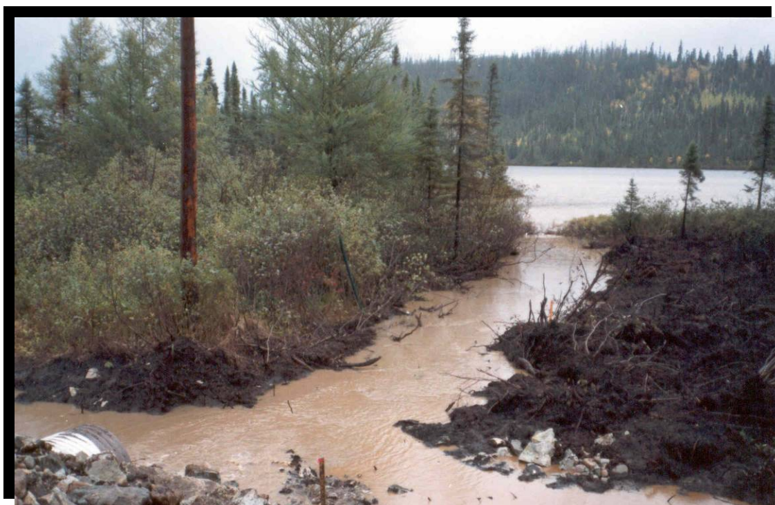
FIGURE 106 Ponceau circulaire en acier (TTOG). Malfaçon en raison d'absence de stabilisation des sols avant la mise en eau du ponceau. (0000.1120)
