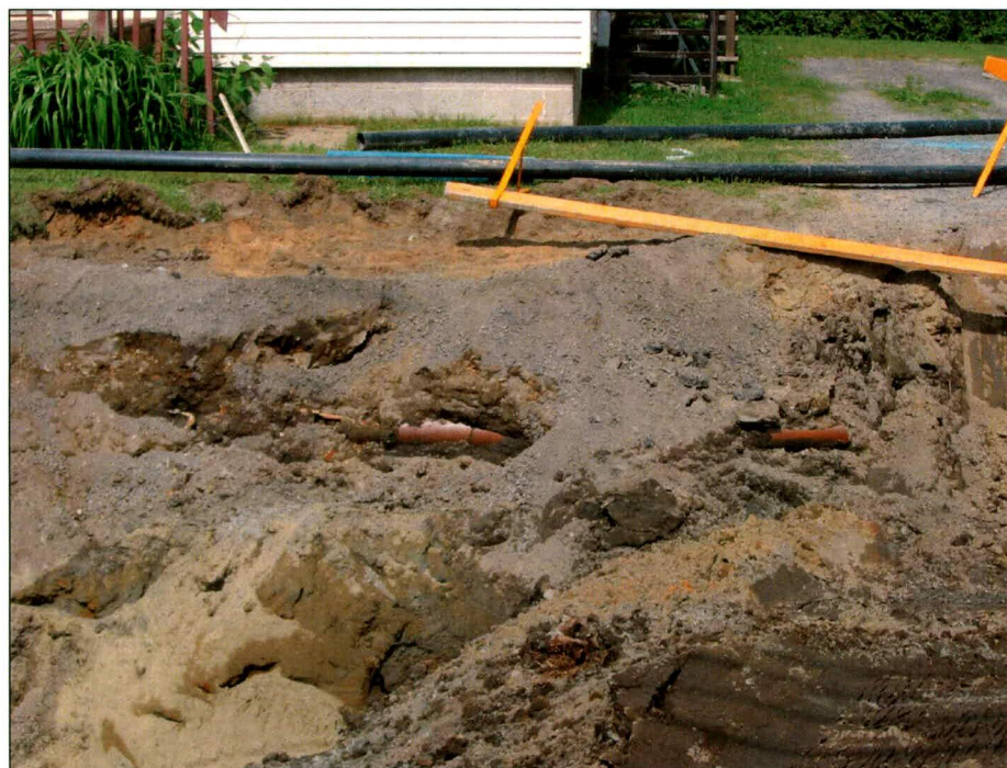
Photo 10 : Saint-Gilles, projet 20-3475-9906, côté est de la route 269, depuis no civique 1575, tuyau en grès visible en paroi. Direction est.
