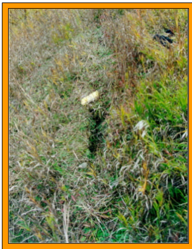
A : Fissure de traction, au sommet du talus (près du calepin de notes)
