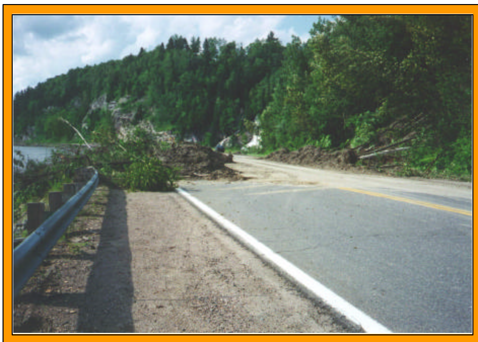
Figure 33 : Route obstruée par les débris d'un glissement de terrain.
