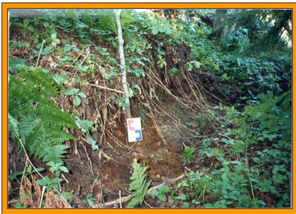
Figure 48 : Fissure de traction avec affaissement de 50 cm, au sommet du talus; rue Henry-McNicoll, La Baie.
