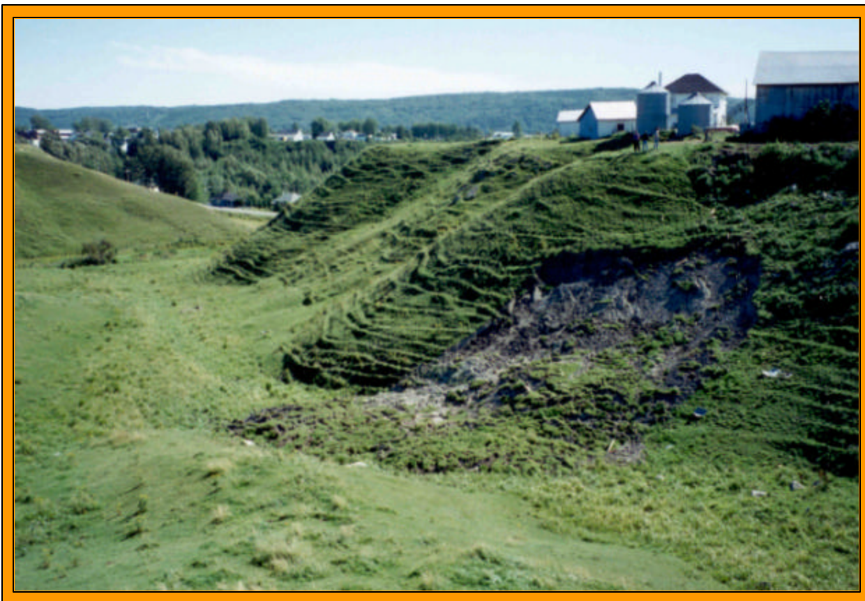
Figure 15 : Talus sans érosion à la base ayant été affecté par un glissement superficiel à Hébertville.
