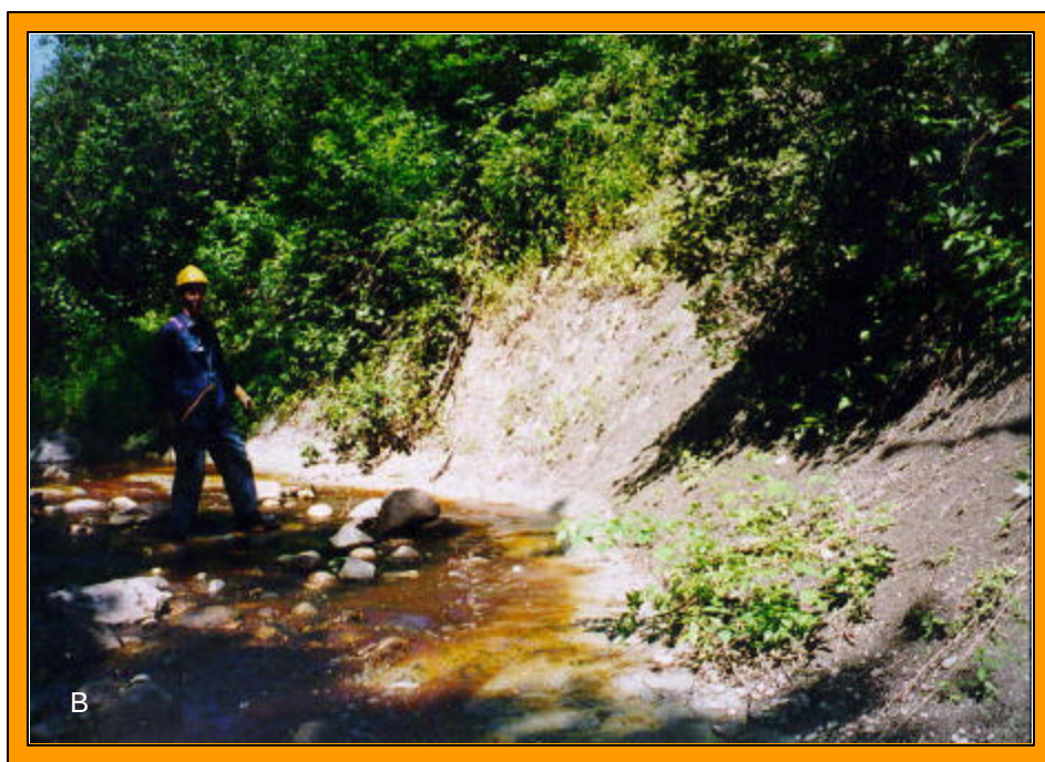
Figure 63 : Exemples d'érosion du pied des talus dans le ruisseau Morissette (zone 2, fig. 53).
