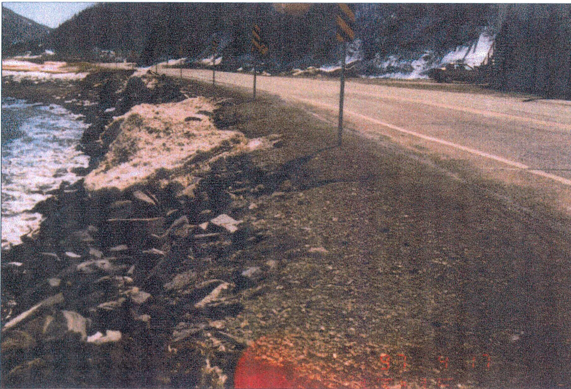
Photo 4.2. État de l'accotement de la route à l'est de la halte routière
