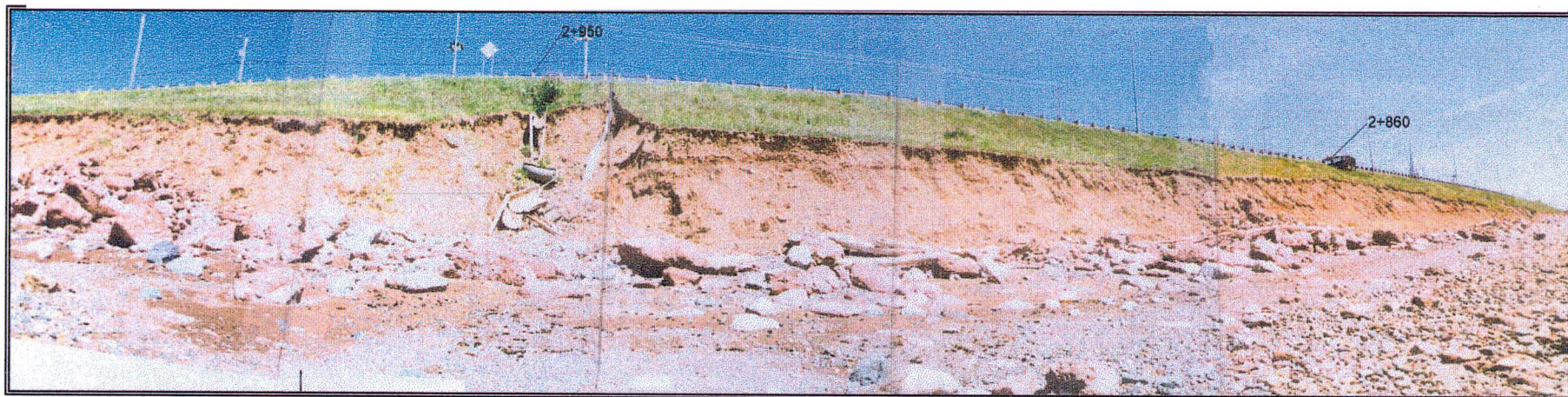
Photo 3.7 : Érosion à la base du talus, ch. 2+860 à 2+950.
