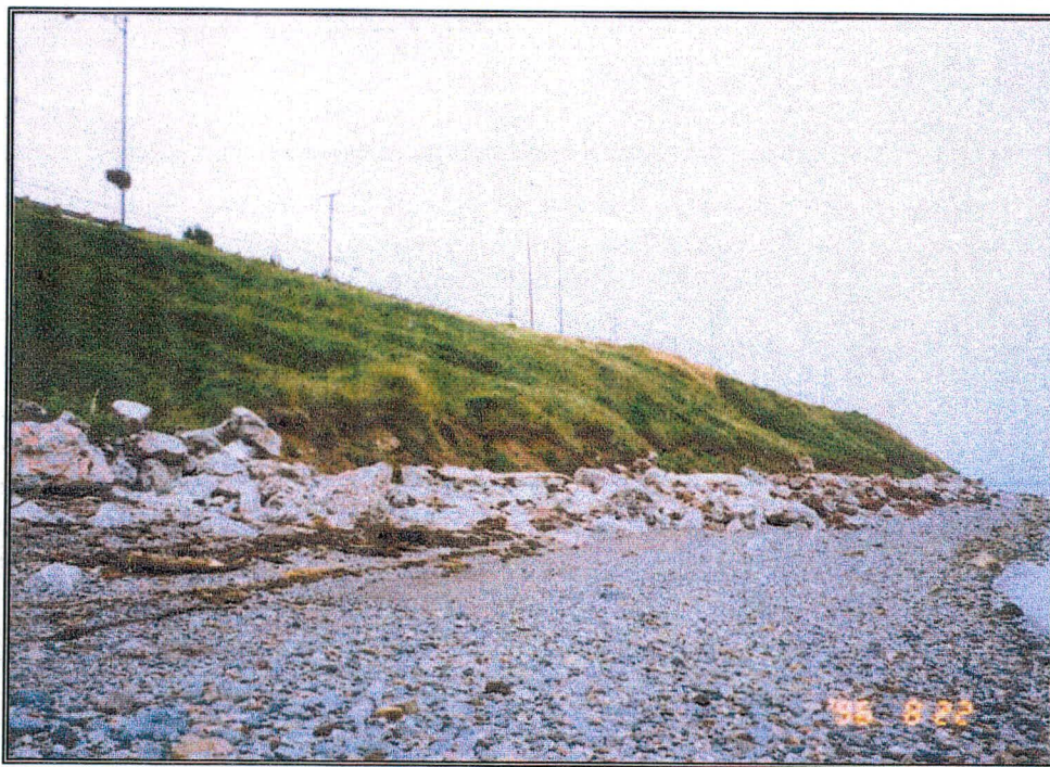
Photo 3.3 : Amoncellements de pierres à la base du talus.
