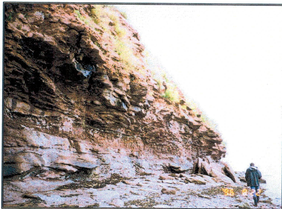
Photo 2.9 : Vides d'érosion à la base de la falaise et surplombs dans le secteur qui reste à protéger par un enrochement.
