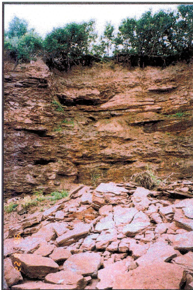
Photo 2.2 : Écroulement à l'ouest du viaduc de la voie ferrée.
