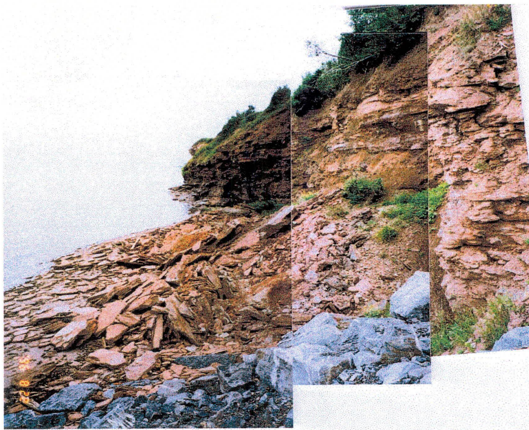
Photo 2.3 : Vue des matériaux d'éboulis de l'éroulement à l'ouest du viaduc de la voie ferrée .
