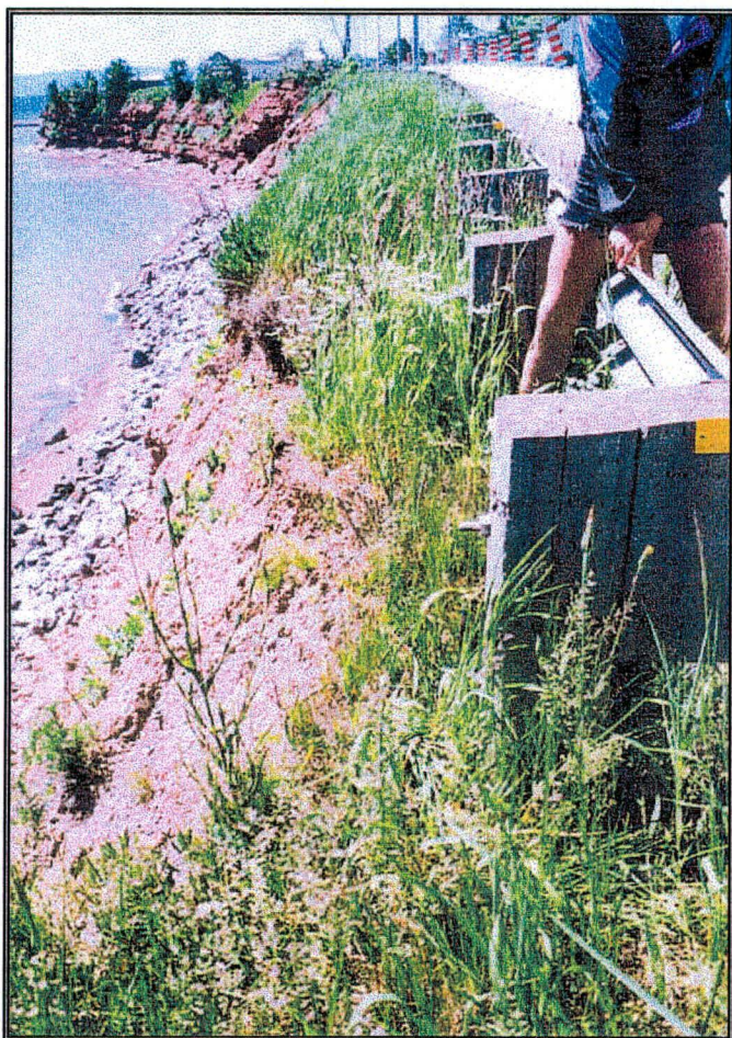
Photo2.1 : Érosion en sommet de talus, ch. 0+250. Un mur de soutènement sera construit dans ce secteur.
