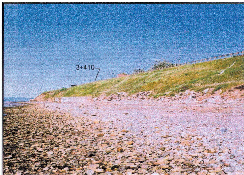
Photo 3.10 : Végétation dans le talus et le mur entre les chaînages 3+410 et 3+480.
