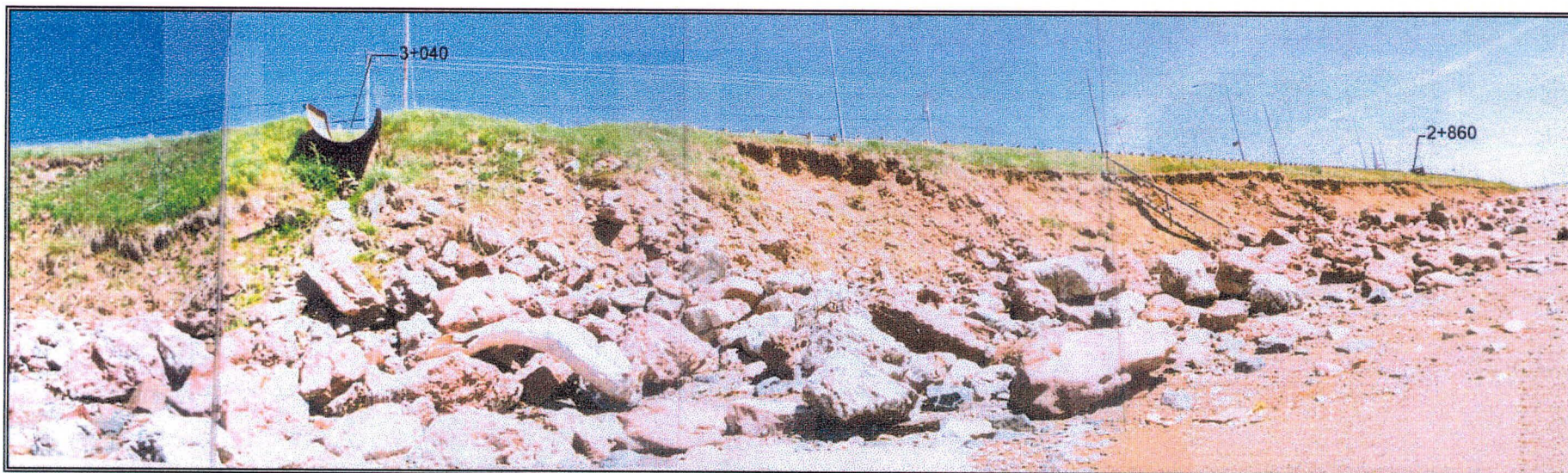
Photo 3.8 : Érosion à la base du talus, ch. 2+950 à 3+040.
