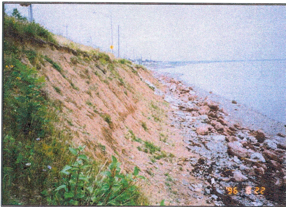
Photo 3.4 : Régression importante du talus, ch. 2+480 et 2+910.
