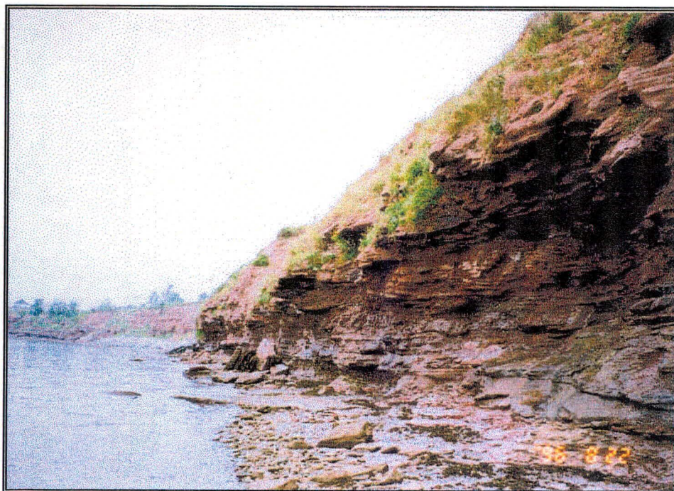
Photo 2.8 : Vides d'érosion à la base de la falaise et surplombs dans le secteur qui reste à protéger par un enrochement.
