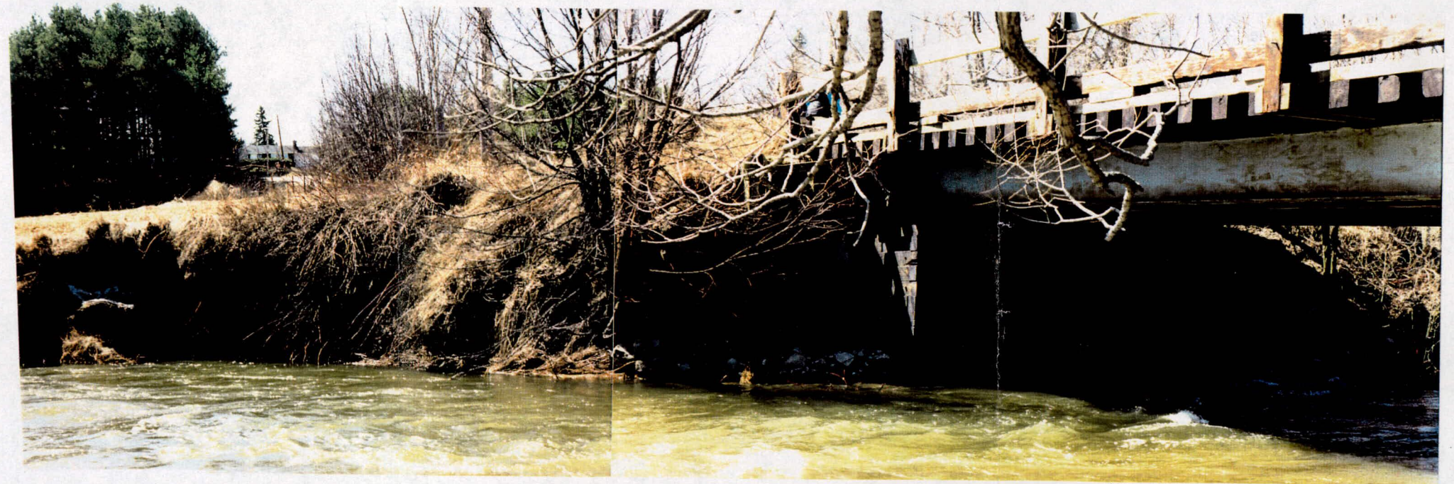
PHOTO 6 : RIVE GAUCHE DE LA RIVIERE LA PECHE, LA CRUE PRINTANNIERE AMENE L'EAU JUSQU'A LA CULEE
