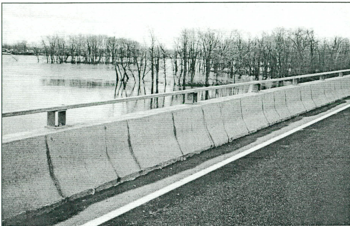
Figure 1 : Fissuration transversale du parapet observée après reconstruction
