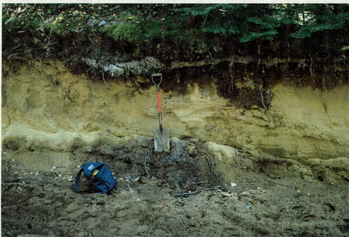
Photo 7: Profondeur de l'érosion du versant sud du chemin de terre au km 0+100 (section 1), vers le sud.
